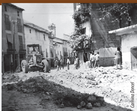
Fig. 6. Retirada de los acarreo arrastrados por una riada procedente de las cuencas deforestadas de los arroyos de la margen derecha del río Pra en la calle principal de Tendilla. 1971
